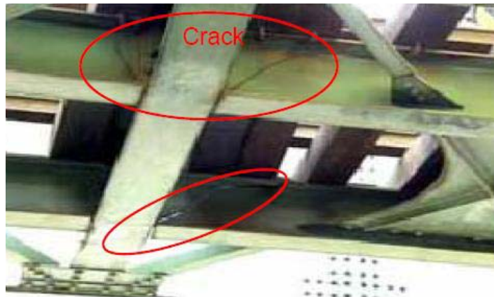
شکل (۳). ترک ایجادشده در پل راه آهن
