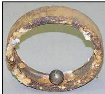
شکل شماره ۳ فرسایش ناشی از نفوذ آب
